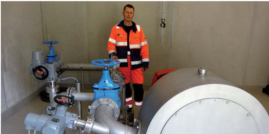
Wassermeister Gerhard Thurner kennt sich mit dem modernen Steuerungssystem im neuen Trinkwasserkraftwerk Marbach II aus.
