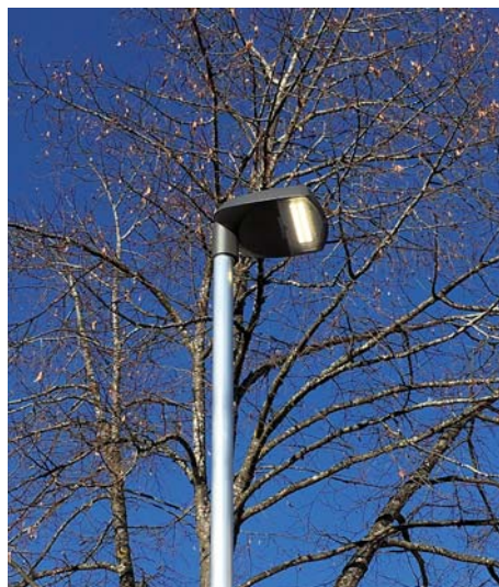
So sieht die neue Straßenbeleuchtung aus. Eine Musterlampe befindet sich bei der Feuerwehrzeughütte. Foto: G. Thurner
